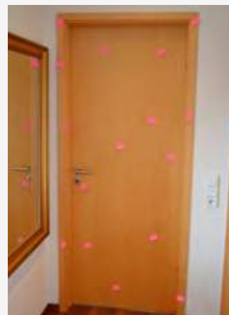
Eine solche Abnahmesituation ist nach den Regelwerken nicht zulässig. Die Markierungen sind vor der Prüfung zu entfernen.
